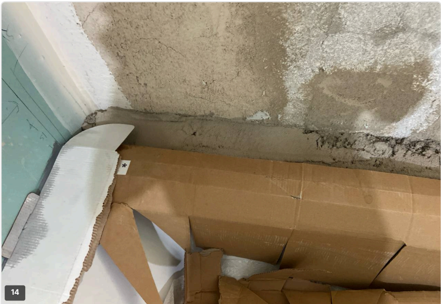
Baño 1 — encuentro de muro y panel en zona de fachada
